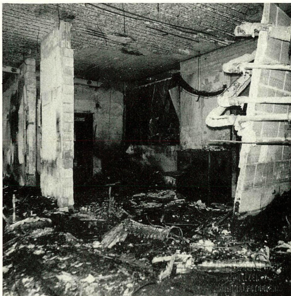
Fig. 5. Le petit local de service (cuisine à café) où l'incendie s'est déclaré. The small service area (coffee kitchen) where the fire broke out.
