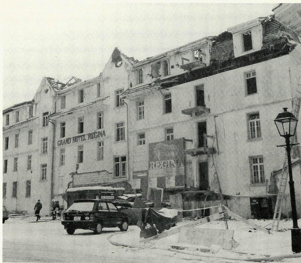
Les rénovations impliquent des dangers d'incendie particuliers. Renovations can bring a number of specific fire dangers.
